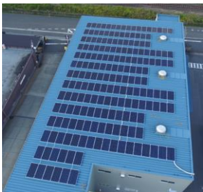
太陽光発電設備
